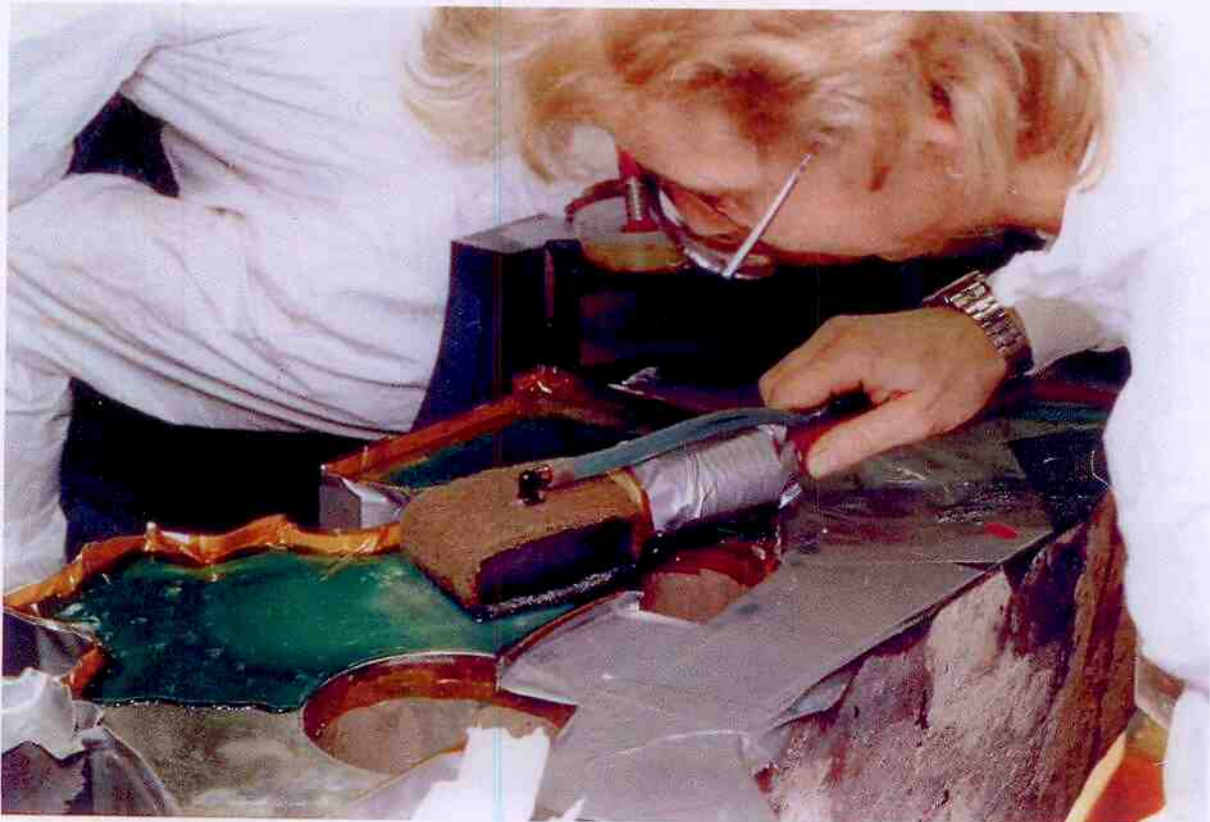
Opbrengen van een nikellaagje op de deelflens van het turbinehuis d.m.v. "tampongalvaniseren".
